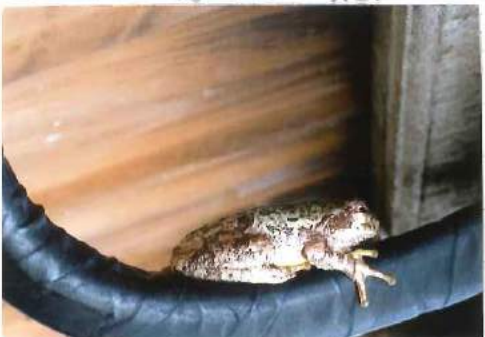
電気メーターの上
